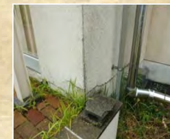
外壁劣化状況(クラック)
