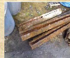
厨房排水管腐食
