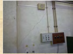
老朽化状況(壁クラック)
