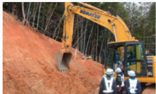
ICT 活用工事 (GPS 及びドローンを利用した法面工事の施工状況)
